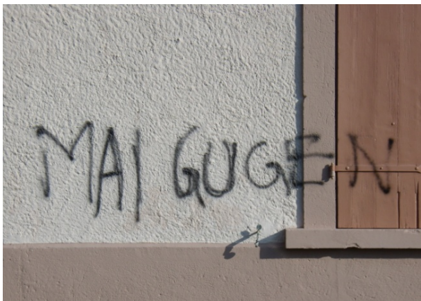
Mit "MAIGUGEN" besprayte Südwand
