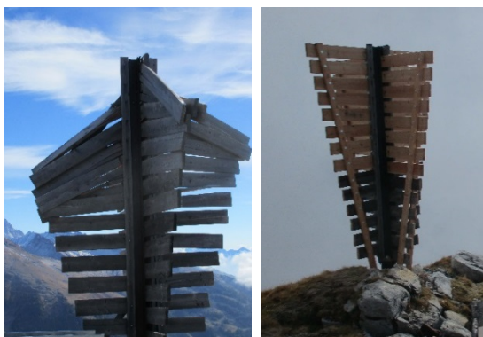
Bretter an Kolktafeln wurden ersetzt u. verstrebt
