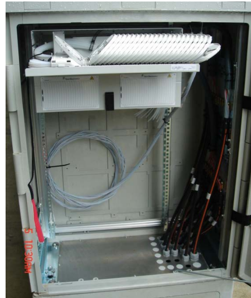
Verteilschrank im Quartier
