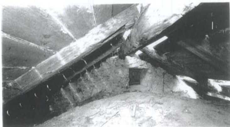
Blick gegen Norden, Die Estrichwand weist deutliche Brandspuren in Putz und Mauerwerk auf. Die Fälldaten der Hölzer des Dachstuhls datieren in den Herbst/Winter 1740 n. Chr. Die Hölzer weisen den Dorfbrand von 1741 in die erste Vegetationsphase Winter/Frühling dieses Jahres aus.
